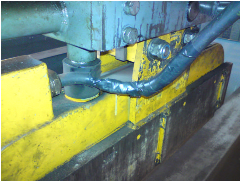
Figure 1: Schlecht gewartete und reparierte Leitungszuführung
