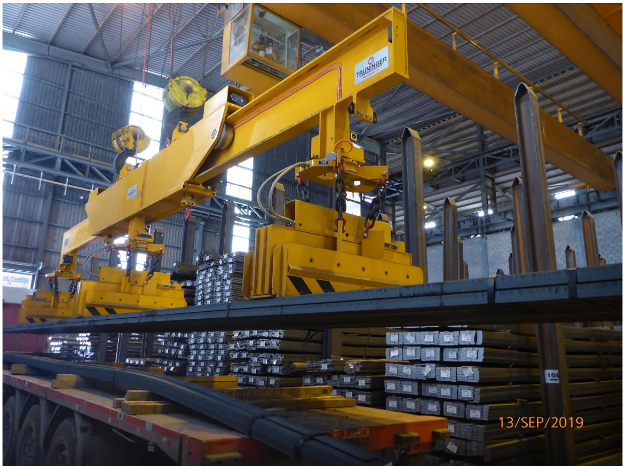
Fig. 3 Redundante Magnetanlage für Profil- und Stabstahlbunde
